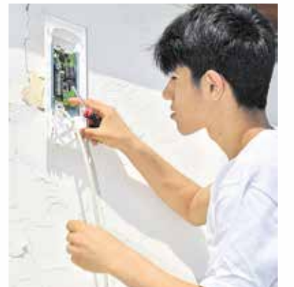
Ismael installiert während seines Tagespraktikums bei der Bolduan electronic GmbH eine Alarmanlage an einem Jugendtreff in Staßfurt, in den mehrfach eingebrochen wurde.
