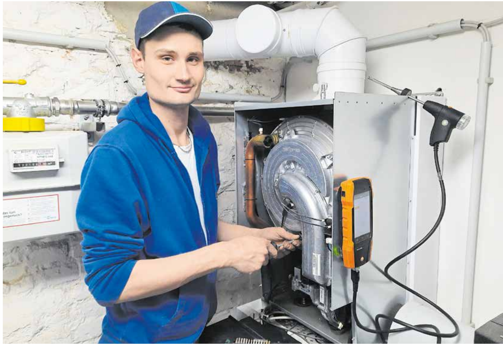
Er installiert und wartet Anlagen, zusätzlich führt er die Geschäfte. Seit 2018 ist René Winkler Inhaber des Meisterbetriebs Gunther Winkler Heizung-Sanitär in Lützen.
